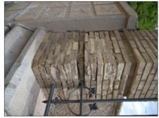
Erosión en la fábrica
