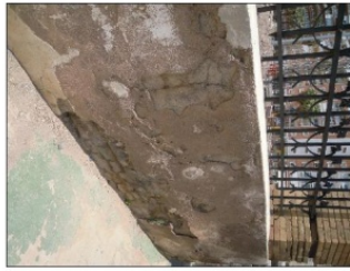
Humedades de capilaridad
