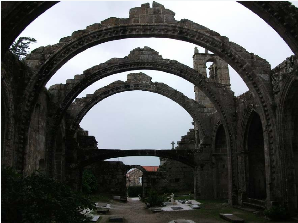
Fig. 2. Cementerio de Santa Mariña de Dozo, en Cambados (Pontevedra): ejemplo de bello monumento que apenas se mantiene en pie por falta de mantenimiento. Fotografía del autor.
