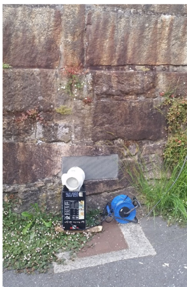
Figura 5.9. Ventilador centrífugo colocado en la salida de la ventilación.
