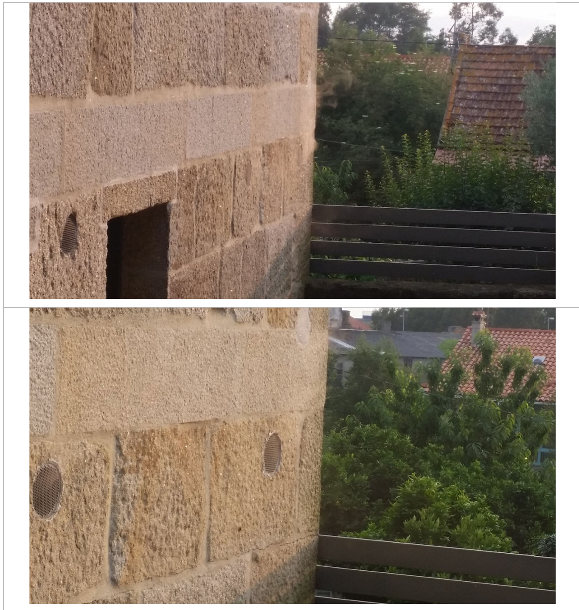
Figura 5.11. Ventilaciones a nivel superior.
