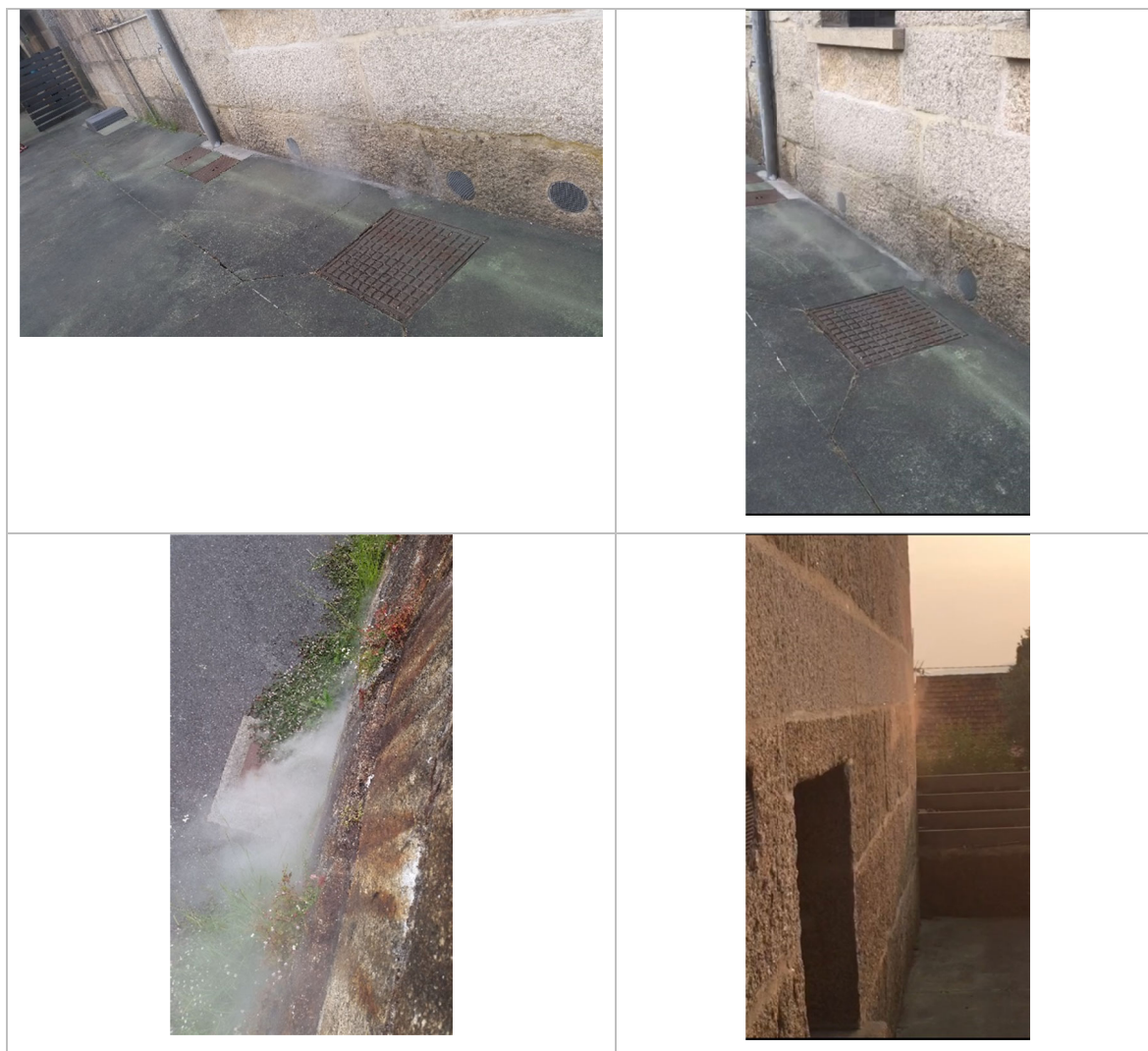
Figura 5.6. Salida del humo por las ventilaciones de la cámara sanitaria.
