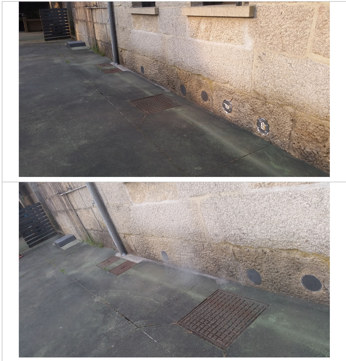
Figura 5.10. Ventilaciones a nivel del suelo.
