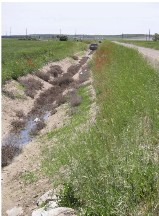
Figura 8. Los cultivos alcanzan el borde del canal de recarga artificial. El espacio entre el canal y la vía de servicio es colonizado por vegetación.
