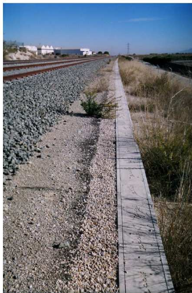
Fig. 17 Canaleta instalada en Sangonera-Librilla. (Fuente: elaboración propia).
