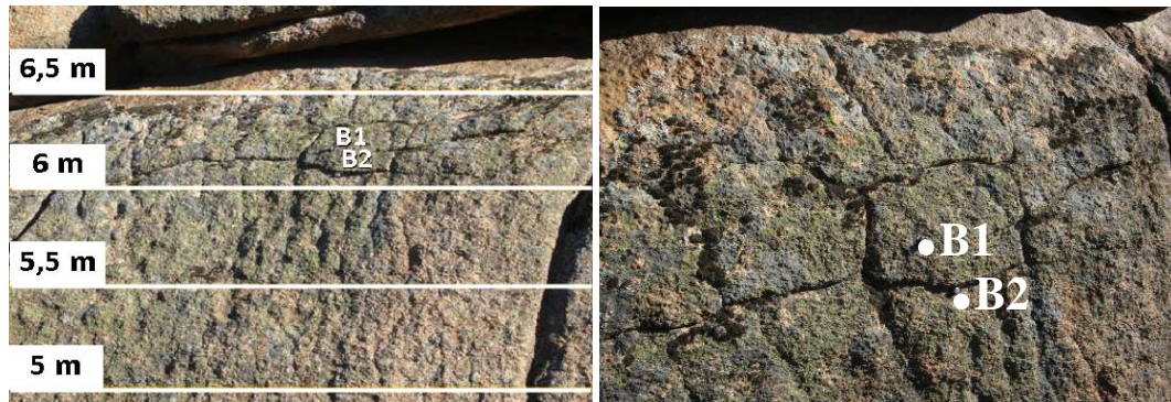
Figura 4.1. Irregularidades en el Murito (tramo 5 a 6 m) y detalle de agrietamientos poligonales.
