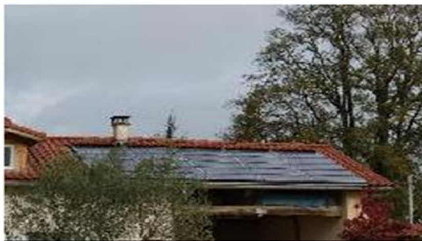
Fig. 2.1 Foto de los paneles solares sobre el tejado
